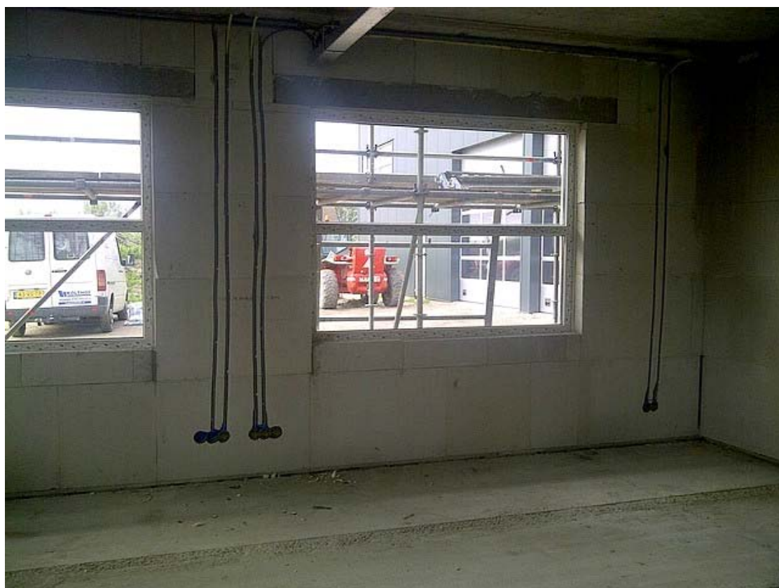
Uiteraard heeft Johan de technische voorzieningen geheel zelf uitgedacht en aangelegd
