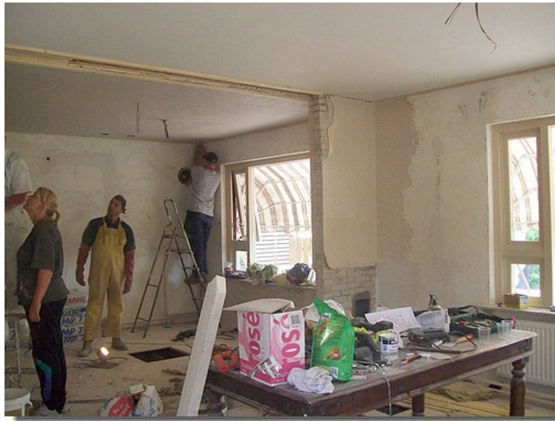
De stukadoors zijn druk aan het werk in de mooie, ruime en lichte woonkamer.
